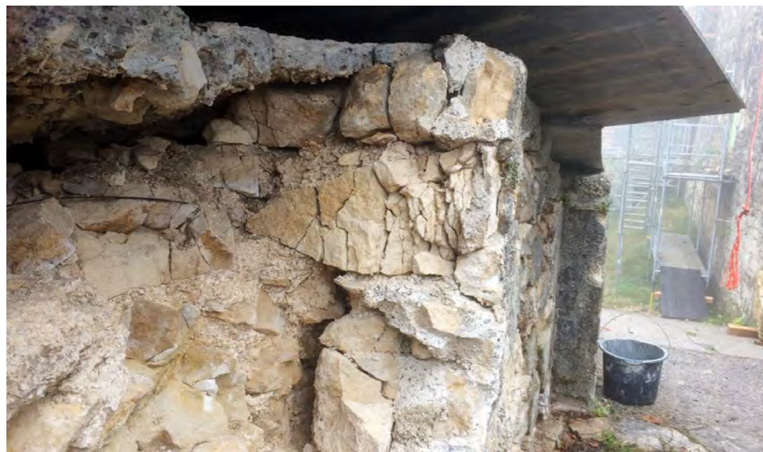
Abb. 3: Farnsburg, typisches Schadensbild. Frostschäden selbst im originalen Mauerwerk mit Zementverputz der Sanierung der 1930er-Jahre. Der Hauptrogenstein, nicht frostbeständig, ist weitgehend zerbröseln. Zudem hat sich die Mauerschale gelöst. Da hilft leider nur noch Rück- und Wiederaufbau. Foto: Gutscher
