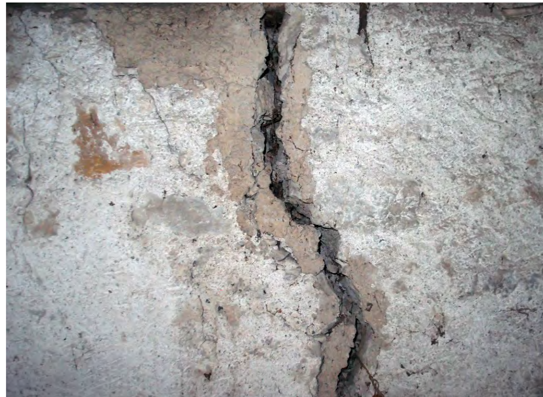
Abb. 5: Die Rissufer zeigen eine horizontale Verschiebung.
