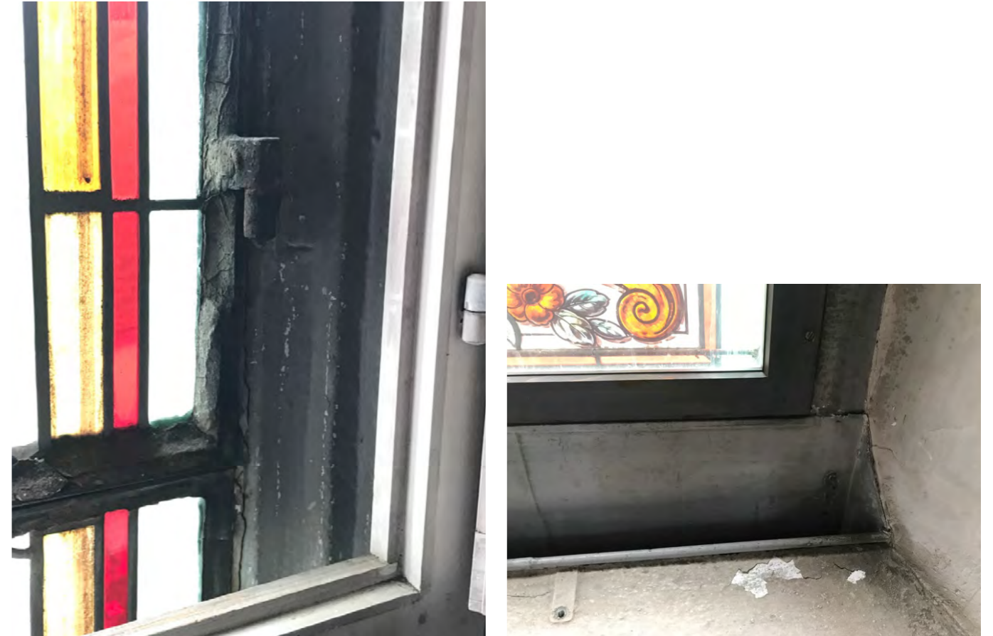
Abb. 11: Ein zusätzlicher innerer Falz (rechts nahe dem Holzfensterrahmen von 1971) und die innere Wasserrinne an den Fenstern bei der Empore
