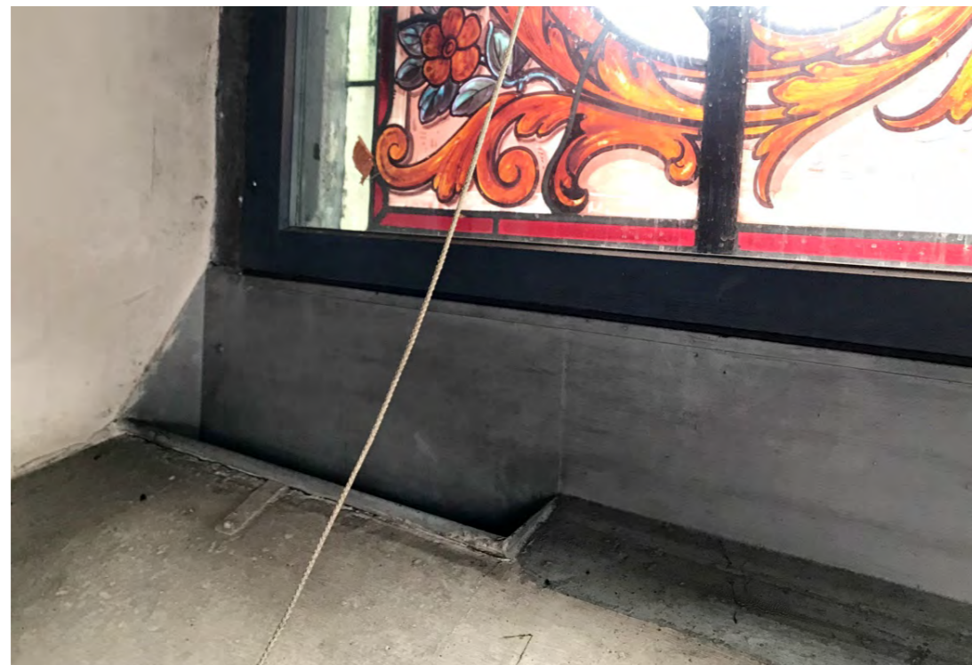
Abb. 10: Unterbrochene innere Schwitzwasserrinne beim Fenster Nr. 2
