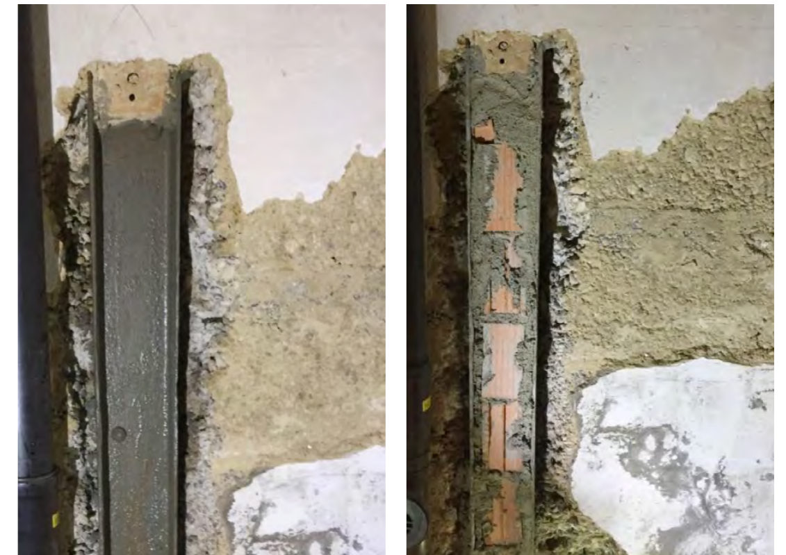
Abb. 5 und 6: Stütze nach Applikation des Korrosionsschutzanstrichs (links), Ausfachung der Stütze mit Backstein vor Verputzung der Mauer (rechts). Fotos: Hans-Ulrich Iselin, 7.7.2020
