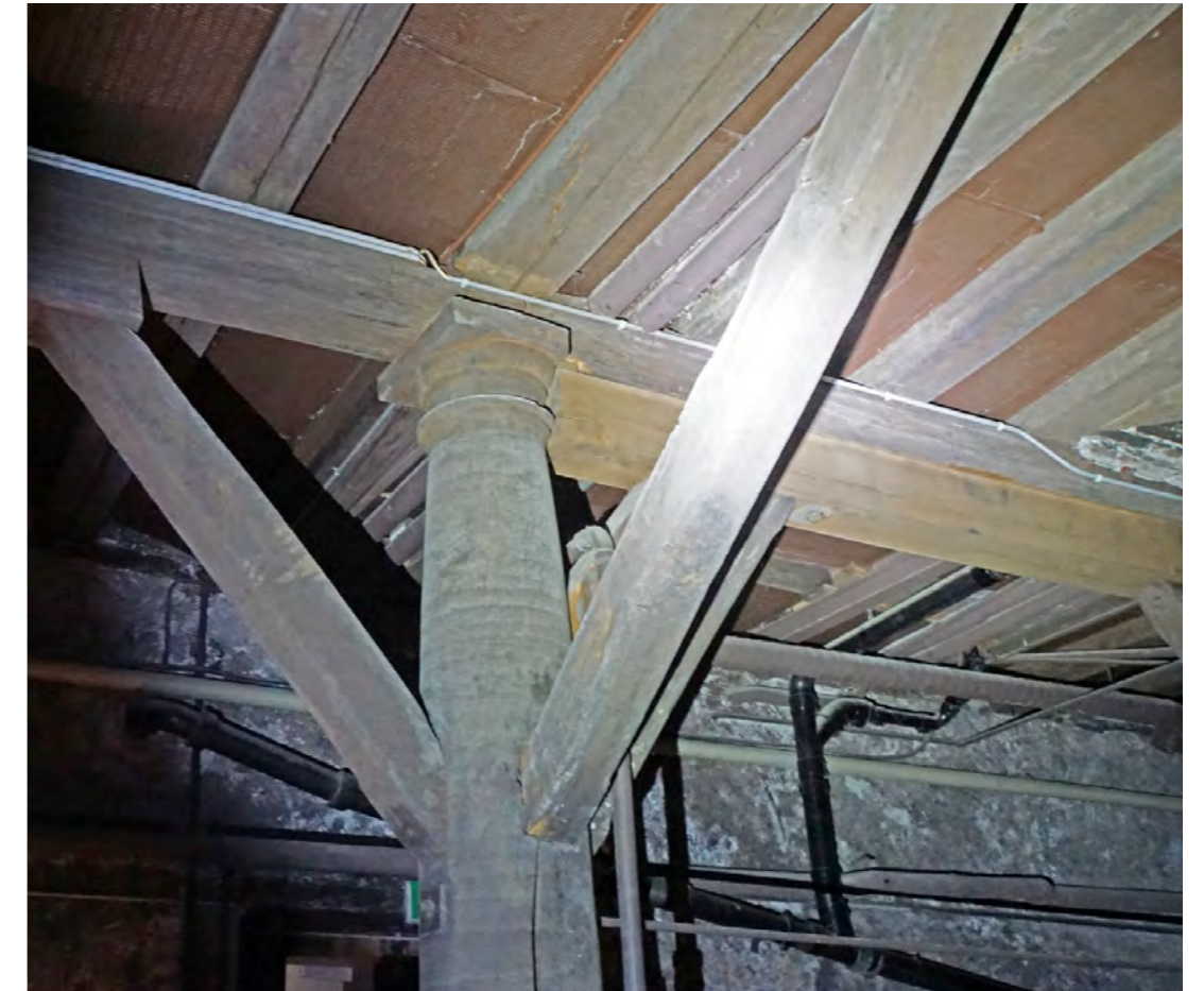
Abb. 1: Eichenholzsäule und notdürftig reparierter, stark verformter Hauptunterzug im Kellergeschoss
