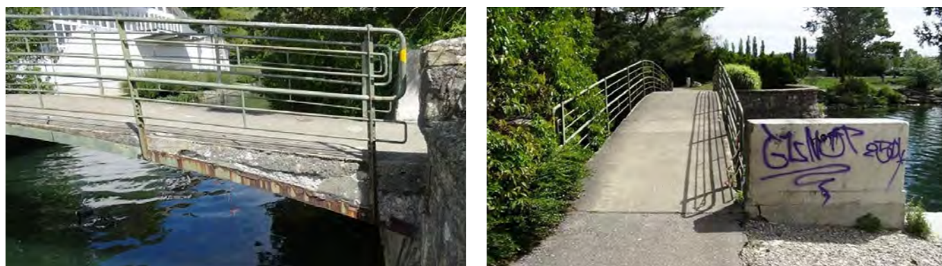
Abb. 21, 22, 23 und 24: Bauwerkszustand: Oberfläche des Mörtelüberzugs; Untersicht des Bogens mit Zeichen von Bewehrungskorrosion und durchlaufendem Wasser; an der Aussenfläche beschädigter Aufbeton im Kämpferbereich des Bogens; Auffahrtssituation (Steigung etwa 8%) Seite Vingelz mit Betonblock ohne offensichtliche Funktion
