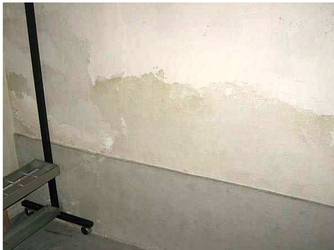
Abb. 1: Feuchteschäden am Mauerfuss an der Nordseite der Kirche. Foto: Architekt Thomas F. Peterer (Foto Nr. 5)
