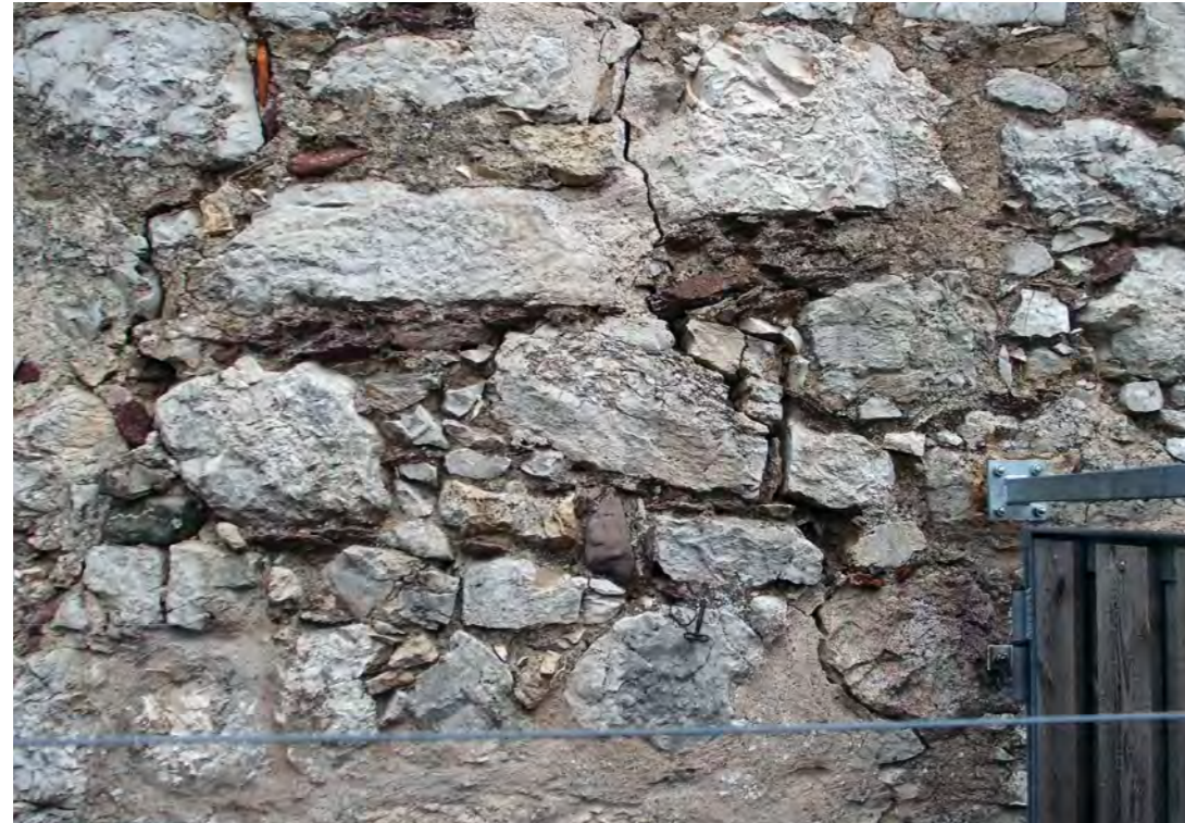
Abb. 4: Risse der Westfassade, Zustand am 4.10.2019
