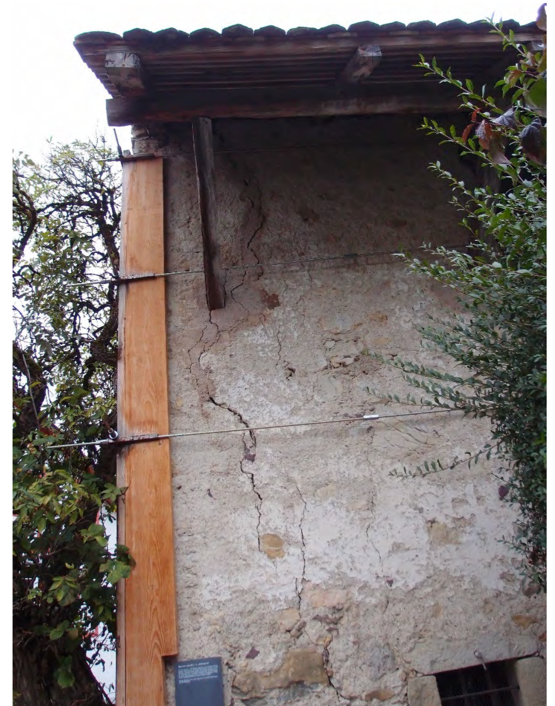
Abb. 3: Risse der Ostfassade, Zustand am 4.10.2019
