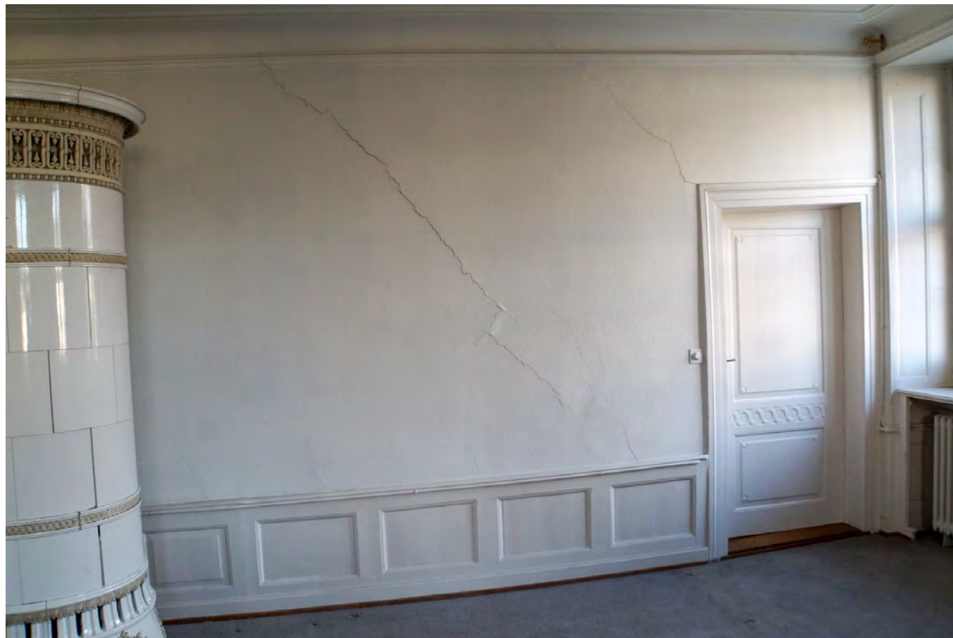
Abb. 2: Typische Risse im Obergeschoss durch Absenkung der gesamten Binnenstruktur des Hauses gegenüber den Umfassungswänden
