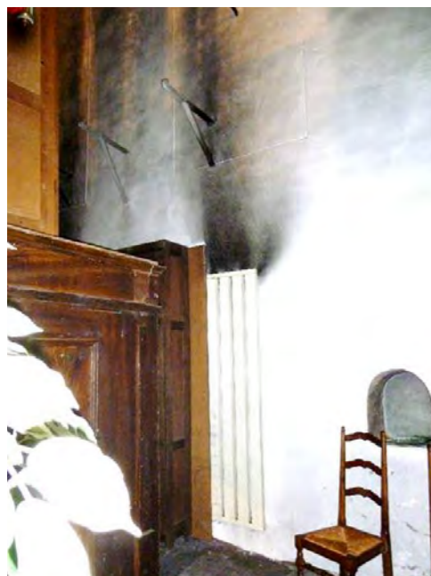
Abb. 3: Wandheizkörper hinter Hochaltar
