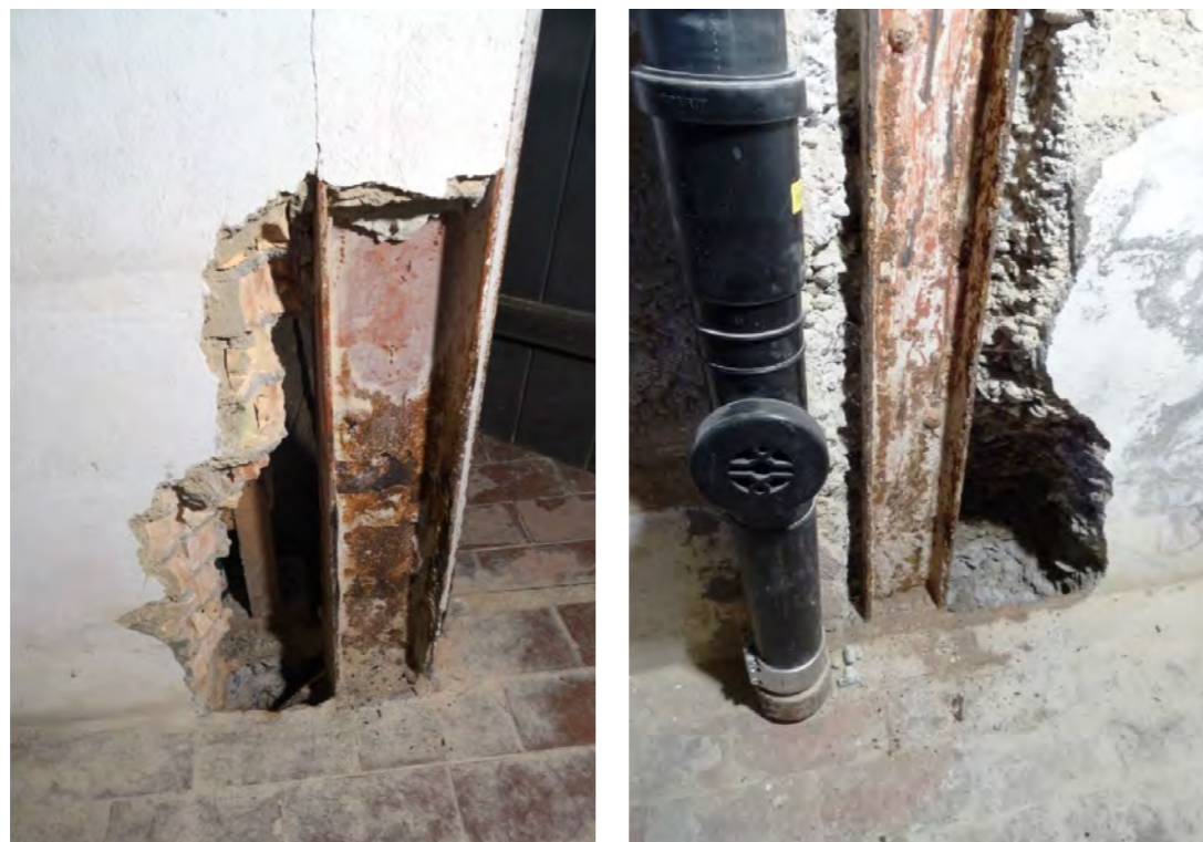
Abb. 3 und 4: Zwei freigelegte Stützen mit Korrosionsschäden. Fotos vom 8.11.2019
