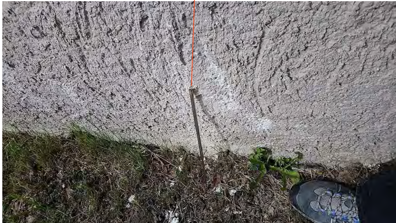
Abb. 4: Mauerstelle im Abschnitt 1. Beim Pfeil tönt der Verputz hohl.
