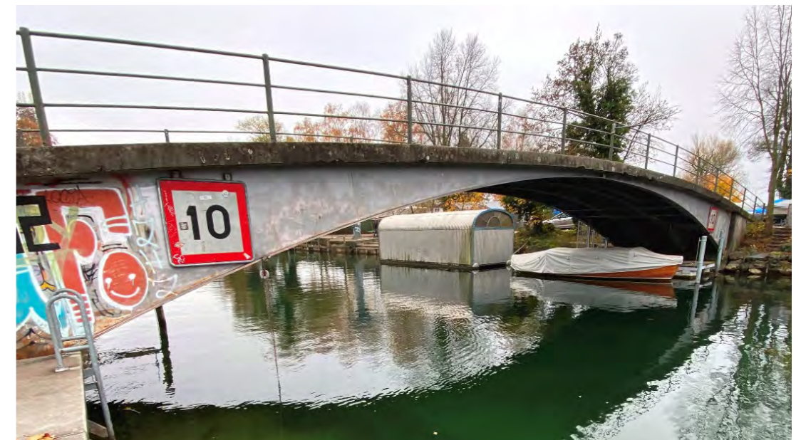
Abb. 10: Bogenbrücke über den Zihlkanal. Diese Brücke ist in der gleichen Bauweise wie die Brücken aus den frühen 1980er-Jahren erstellt worden. Da in den 1930er-Jahren die Stahl-Beton-Verbundbauweise noch eine Innovation war, könnte es sich um einen Ersatzneubau aus den 1970er- oder frühen 1980er-Jahren handeln.
