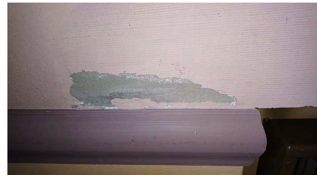
Abb. 4: Schaden an der Nordwand im Unterweisungsraum nahe der Nordwestecke
