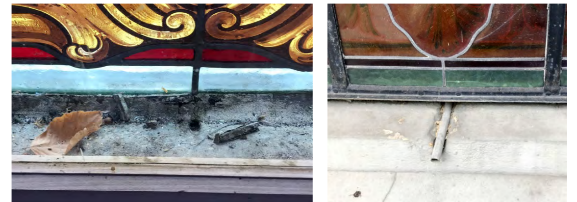
Abb. 7: Innenseite der Bleiverglasung, untere Schwitzwasserrinne mit dem Abflussloch in ein Röhrchen gegen aussen
