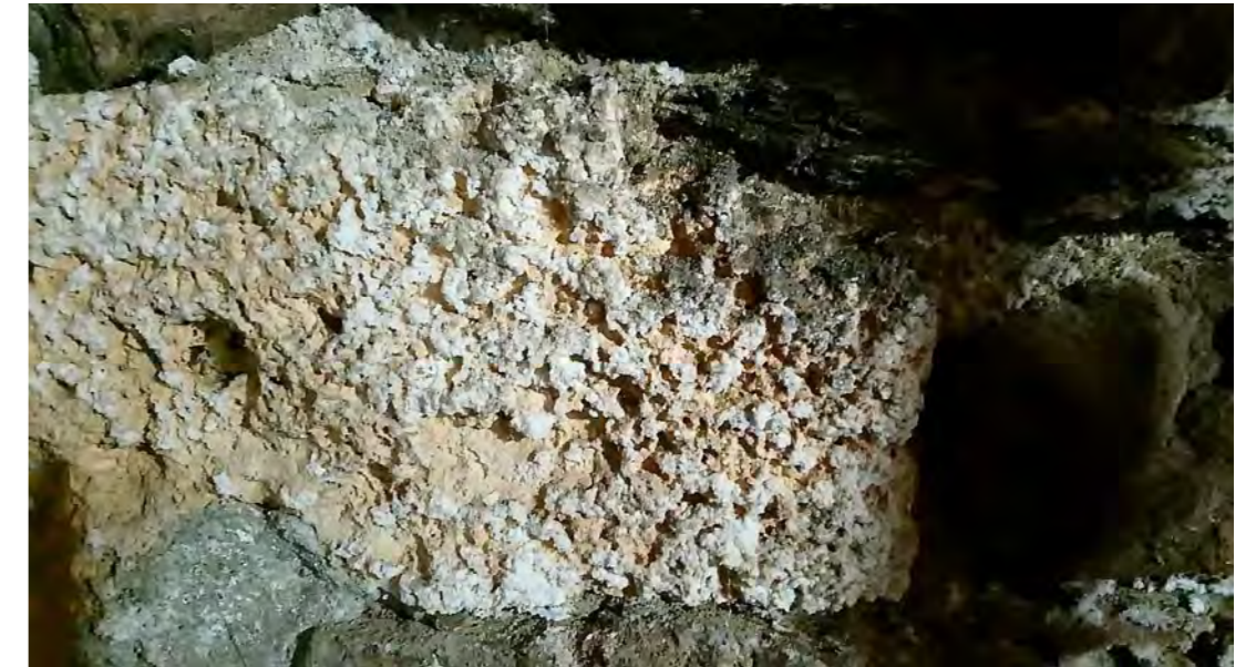
Abb. 1: Salzausblühungen auf vermutlicher Rauwacke
