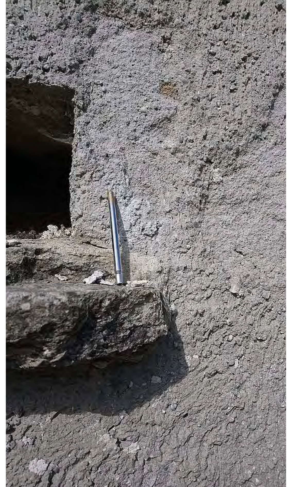
Abb. 6: Detail der Verputzschäden in der Bildmitte von Abb. 1
